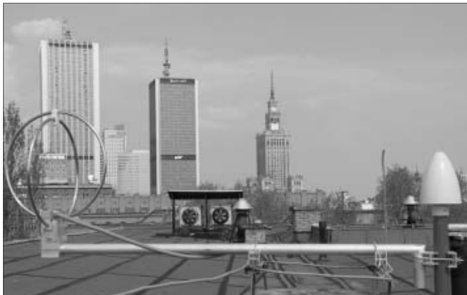
Widok identycznej anteny zainstalowanej na budynku Politechniki Warszawskiej.
